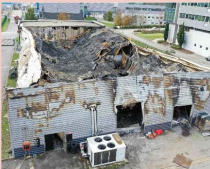
Atelier de production détruit suite à l'incendie
